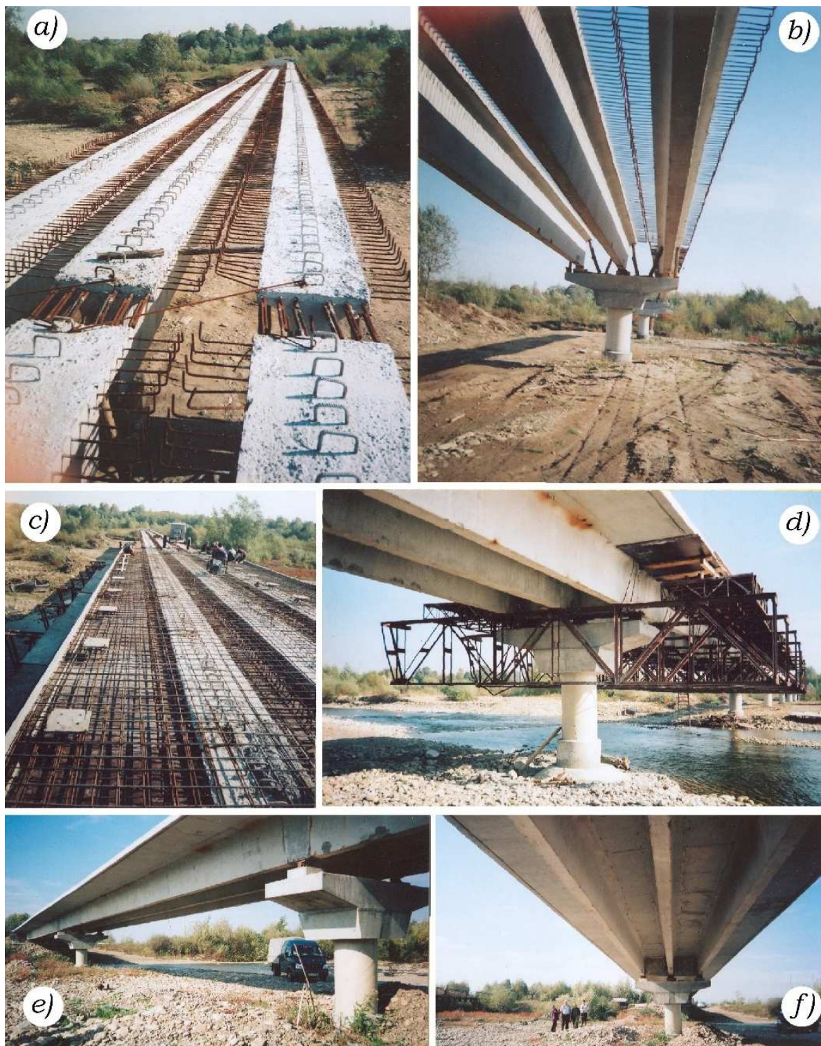
Rys. 4. Widok zmontowanych dźwigarów z góry (a) i z dołu (b), płyty pomostowej (c), podwieszonego deskowania(d), płyty pomostowej. Ogólny widok części przęsłowej konstrukcji (e, f)
