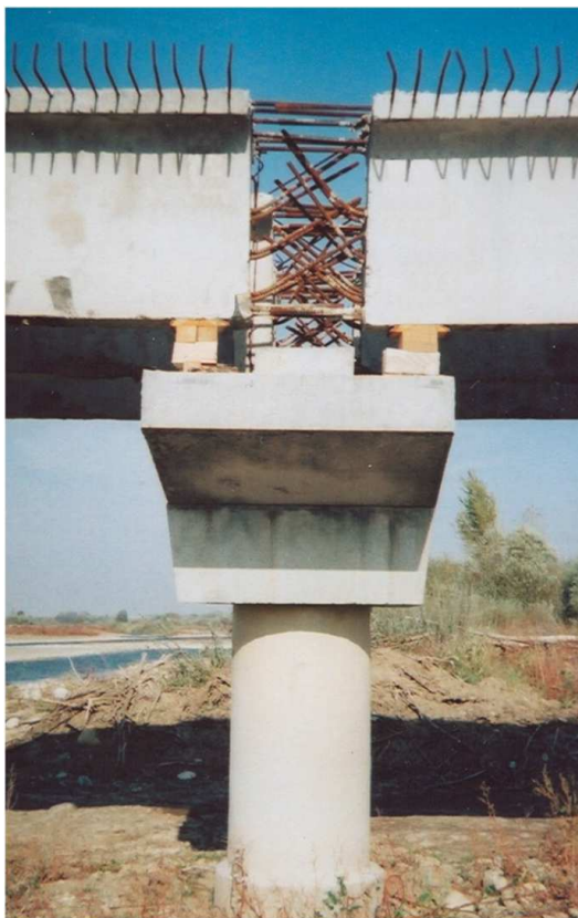
Rys. 3. Filar z opartymi na tymczasowych podporach drewnianych dźwigarami, widoczne zbrojenie czoła dźwigarów
