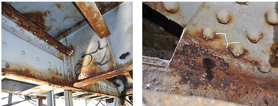
Rys. 2. Węzeł górny (widok od wewnątrz), widoczna korozja powierzchniowa i wżerowa podłużnic oraz korozja wżerowa i powierzchniowa blachy oraz nitów
