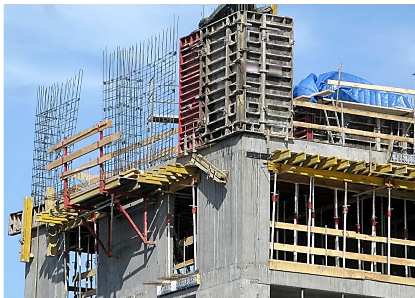
Rys. 8. Deskowania ścian narożnych piątej kondygnacji bez zastosowania pomostów. Montaż dźwigarów wspornikowych przytrzymujących zastawki czołowe stropu grożący upadkiem. Jedyny widoczny pomost bez barier bocznych
