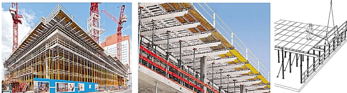
Rys. 9. Bezpieczeństwo na krawędzi stropu: pomosty SKYDECK służą jako rusztowanie roboczo-za- bezpieczające i eliminują konieczność montażu dodatkowych daszków ochronnych lub siatek
