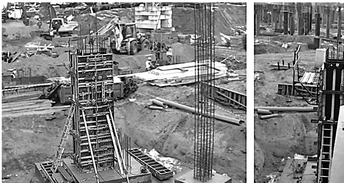
Rys. 5. Nieprawidłowe wyposażenie deskowania słupowego w pomosty roboczo betoniarskie. Poszycie wykonane z przerzuconych górą dźwigarów, brak bezpiecznego dostępu do pomostów
