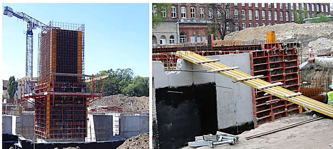
Rys. 7. Inny przykład nieprawidłowego stosowania pomostów roboczo-betoniarskich jako platformy roboczej dla zbrojarzy (z lewej) i kładka nad wykopem, bez barier, złożona z dźwigarów zginanych w kierunku na który nie są projektowane
