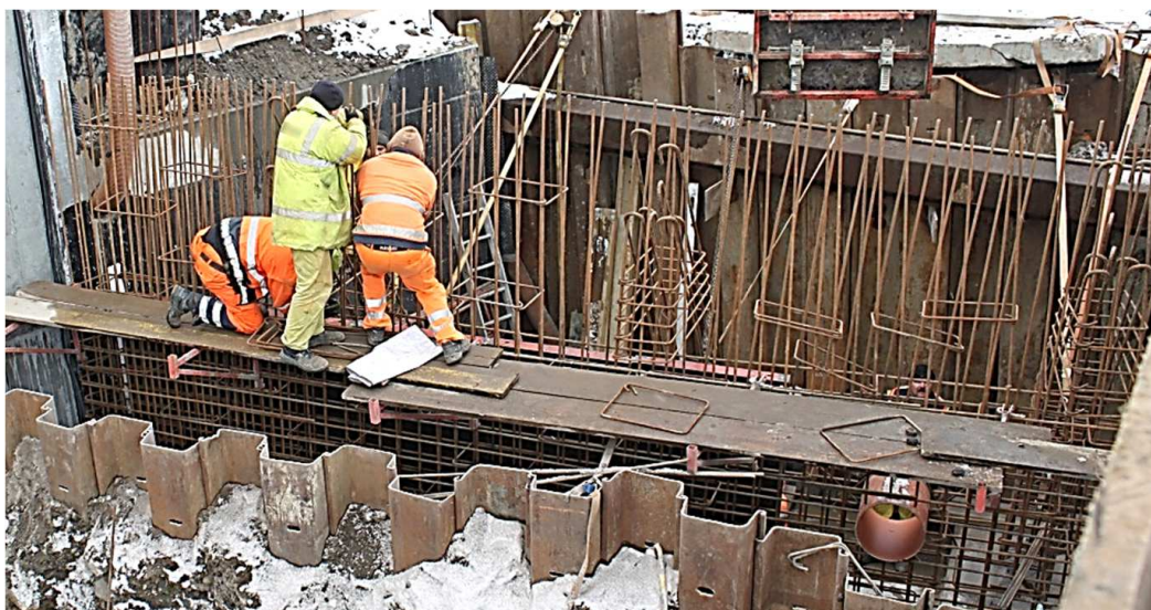
Rys. 4. Niewłaściwie wykorzystywane elementy pomostów betoniarskich, niepełne podesty, brak obarierowania, brak środków ochrony indywidualnej w tym choćby kasków ochronnych
