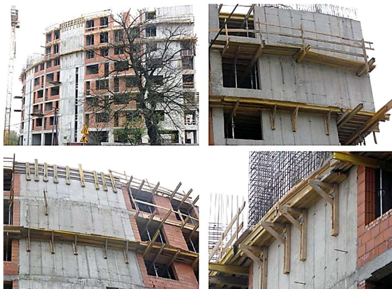
Rys. 3. Miejsce pracy na budowie nie powinno być areną sportów ekstremalnych. Niestety nie w tym przypadku. Widoczne na zdjęciach wąskie, poskładane z przypadkowych elementów podesty, wsporniki podestów montowane do ścian wbrew sztuce budowlanej (zginanie ze ścinaniem prętów ściągowych, które powinny pracować tylko na rozciąganie), brak barier, itd.
