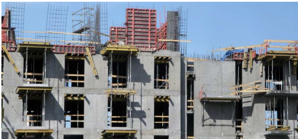
Rys. 1. Rzeczywistość na budowie – brak odpowiedniej ilości pomostów roboczych i betoniarskich, ryzykowne zastawki stropu, niebezpieczny dostęp do pomostu roboczego, nieprawidłowe nadstawianie nad sobą wolnostojących podpór stropowych
