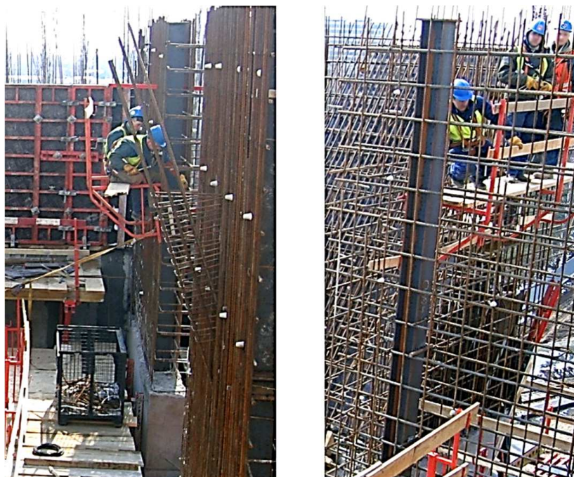
Rys. 2. Prowadzenie robót zbrojarskich z nieprzystosowanych do tego pomostów betoniarskich. Wsporniki takich pomostów wyposażone są w zaczepy gwarantujące bezpieczne połączenie jedynie z ramą odpowiedniego systemu deskowań ściennych
