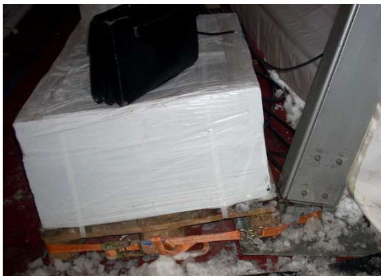
Rys. 6. Balastowanie stopy słupa bloczkami betonowymi na palecie, jako sposób uniknięcia „trwałego zamocowania w gruncie”, fot. PINB
