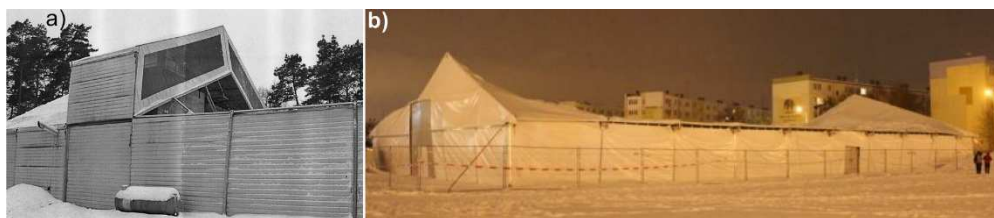
Rys. 1. Zawalone dachy namiotowe, a) magazyn chmielu koło Poznania, b) nad lodowiskiem miejskim w Bydgoszczy. Fot. PINB.
