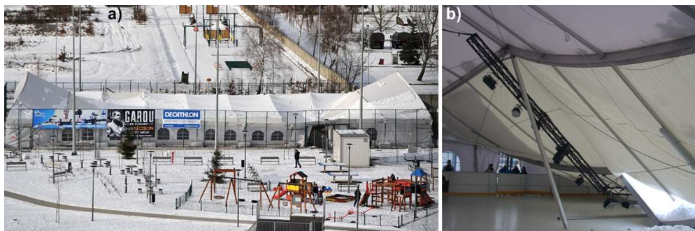
Rys. 2. Zawalony dach namiotowy lodowiska w Szczecinie, a) widok ogólny, fot. Łukasz Szelemej, Radio Szczecin [3], b) zniszczone aluminiowe dźwigary, fot. PINB
