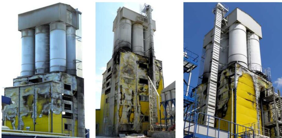
Rys. 3. Zewnętrzne zniszczenia obiektu po pożarze
