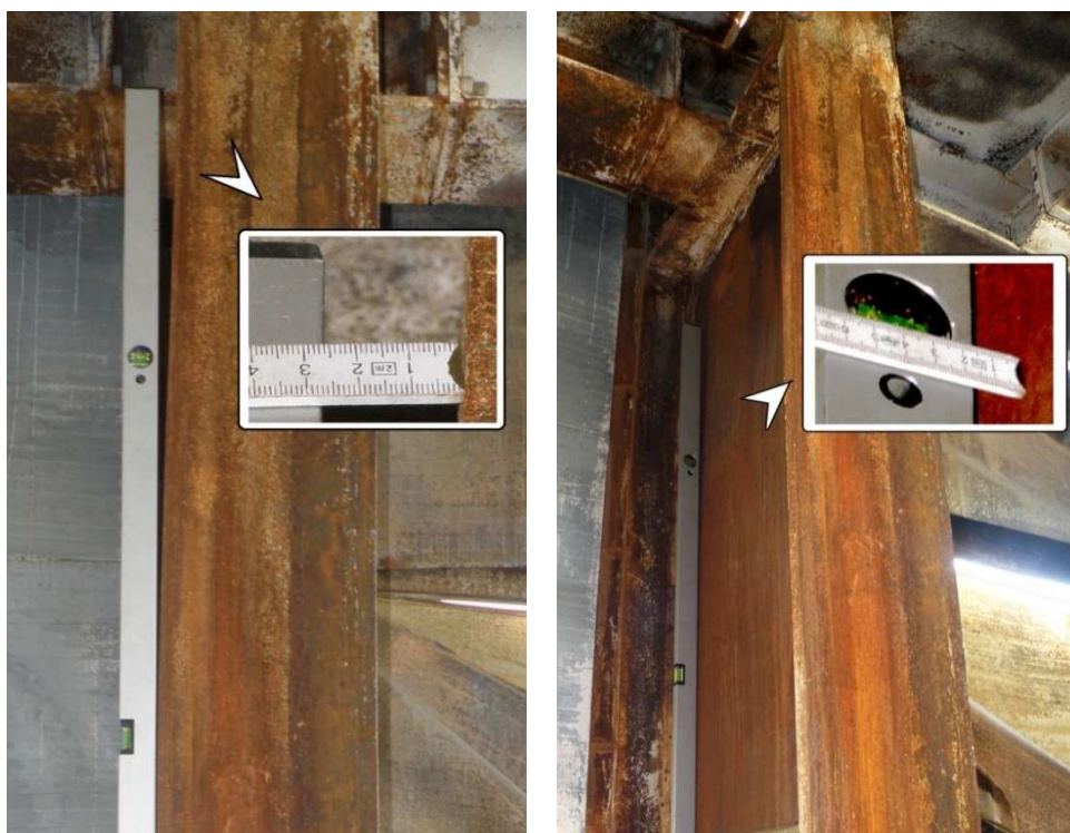
Rys. 5. Deformacje głównych słupów nośnych wykonanych z kształtownika HEB 900
