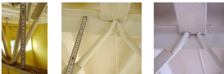
Rys. 9. Przykładowe wady geometryczne wykonania konstrukcji
