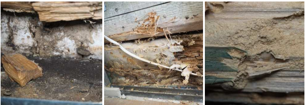
Rys. 9.1–9.3. Porażenie drewna przez grzyb domowy właściwy oraz ślady po żerowaniu szkodnika
