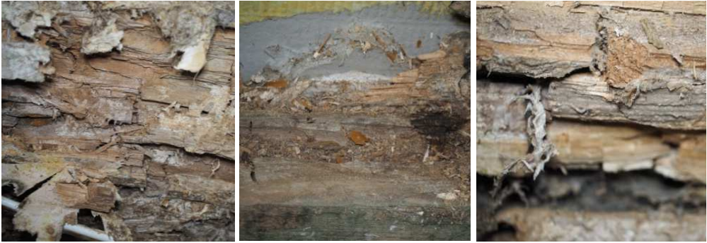
Rys. 8.1–8.3. Dalsze przykłady całkowitej destrukcji drewna w warstwie konstrukcyjnej w ścianie
